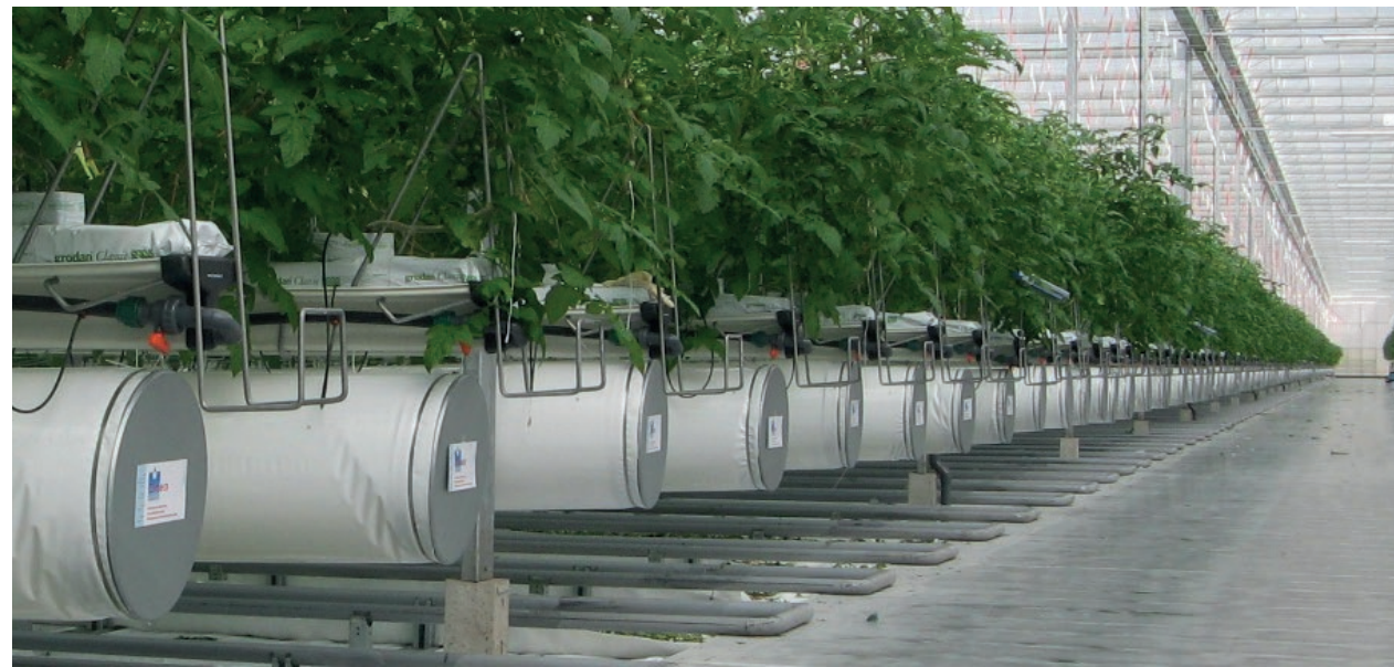
Met de subsidie Energie-efficiëntie glastuinbouw kunnen glastuinbouwers een bijdrage krijgen omdat zij willen investeren in energiebesparing. Foto: PR
